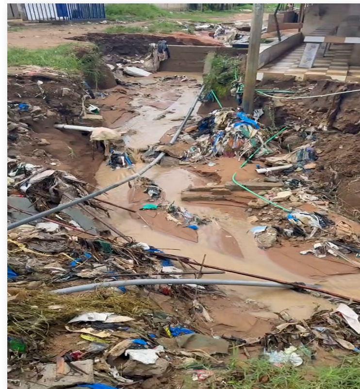
Le flot rejoint la voie publique, chargé de déchets
